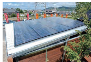
車庫に取付けられた太陽光発電
